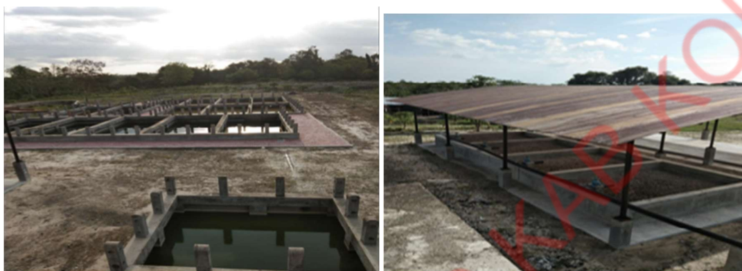
Gambar 3. 9 Sarana Pengolahan IPLT Translik Pasir Panjang
